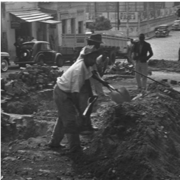
Reconstrução de esgoto na Rua Carijós. 14 de setembro de 1960. Gestão Amintas de Barros.
